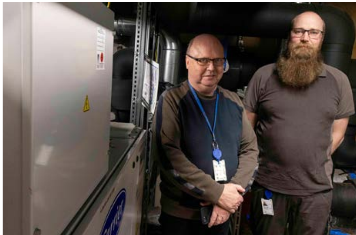
Jan Mathisen, koordinator for teknisk drift ved Diakonhjemmet sykehus, og driftstekniker Stian Dyrdal-Oftedal, er klar for å koble på nye energibrønner inn i energisentralen, som er bygd opp i det gamle fyrrummet på sykehuset.
